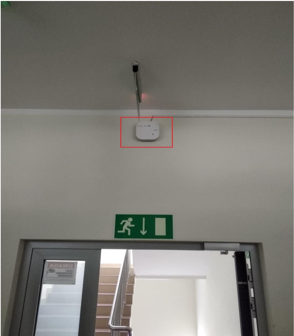
Zdjęcie 1.2. Urządzenie anteny ([miejsce usytuowania])
